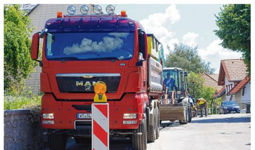
Der Ausbau des Breitbandnetzes, im Bild aktuelle Arbeiten in Niederwihl, kostet die Gemeinde Görwihl 800.000 Euro mehr. BILD: PETER SCHÜTZ
